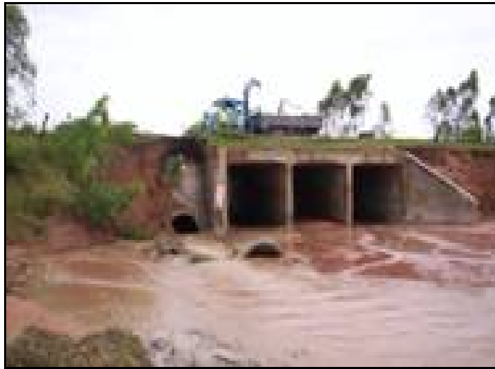
รูปที่ 2 น้ำไหลกัดเซาะบริเวณท่อลอดเหลี่ยมชำรุด (ด้านโครงสร้างระบายน้ำ)
