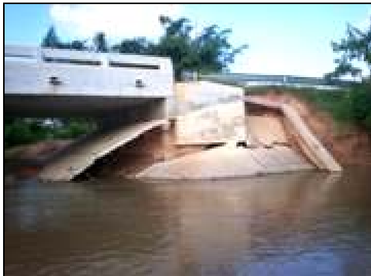
รูปที่ 3 น้ำไหลกัดเซาะบริเวณคอสะพานชำรุดเสียหาย (ด้านโครงสร้างระบายน้ำ)
